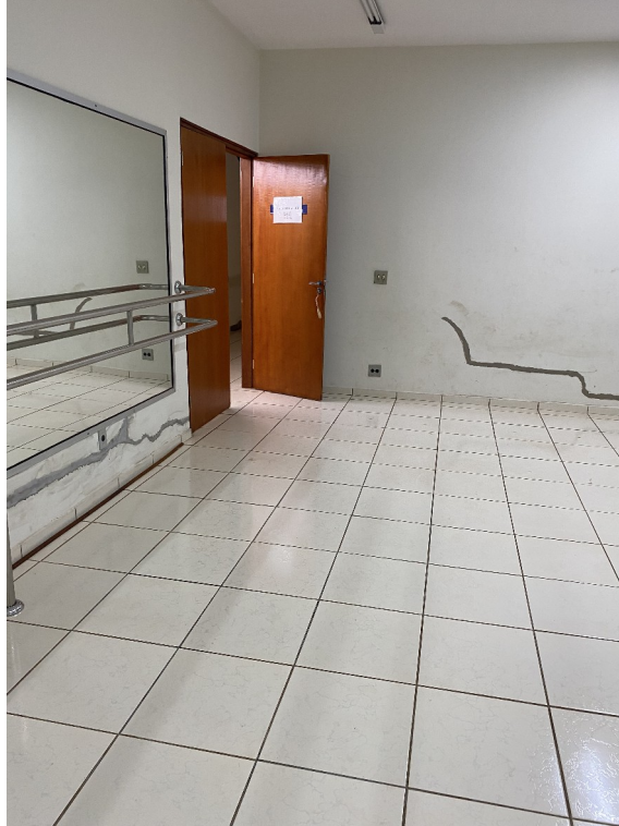
Foto 04 : detalhe sala de dança -piso a ser recuperado.
